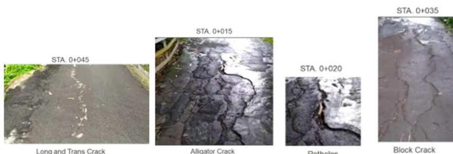
Gambar 2. Visualisasi Kerusakan Permukaan Jalan
