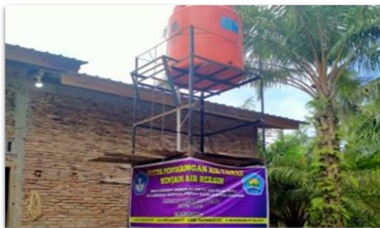
Gambar 6. Instalasi Air Bersih
